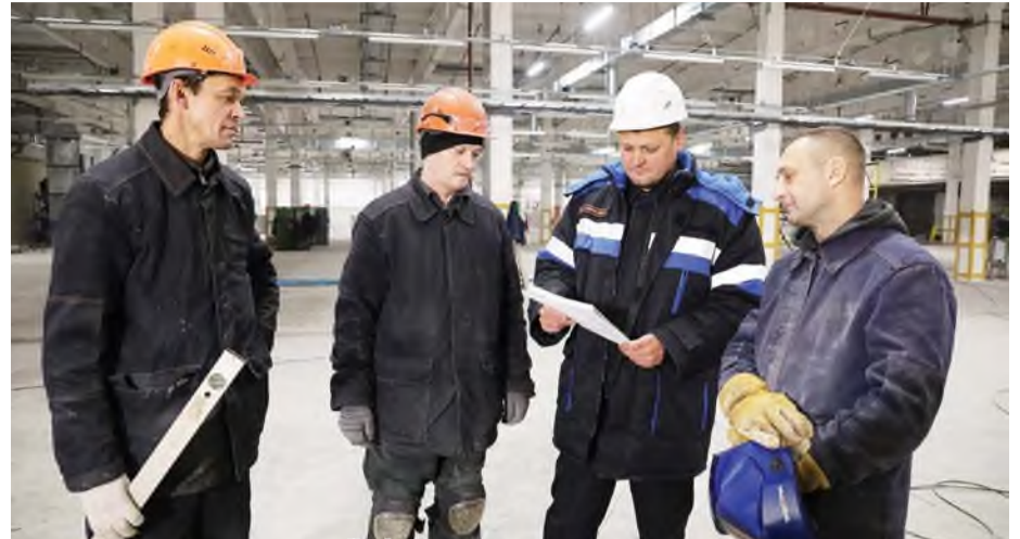
На монтаже металлоконструкций обрамления проёма и монтаж противопожарных ворот звено монтажного участка Александр Васильевич МАРУШЕНКО, электросварщик; Григорий Викторович КРЫЛОВ, электрогазосварщик; Максим Геннадьевич ЛЕОНОВ, прораб; Олег Юрьевич РЫБАКОВ, электросварщик
