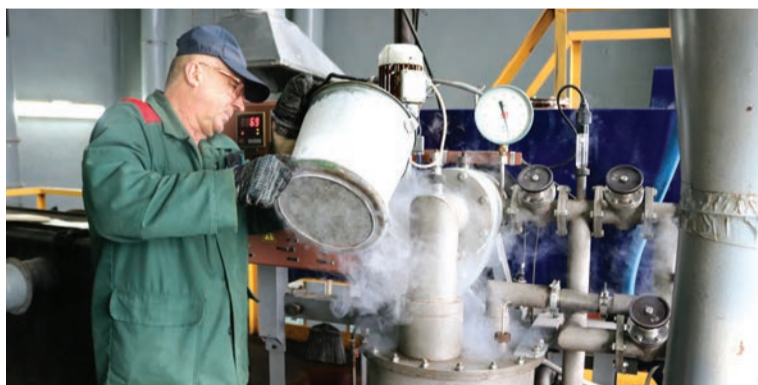
Аппаратчик регенерации 5 разряда ВКНиОСВ Михаил Бусел у термодемеркуризионной установки УРЛ-2м, предназначенной для утилизации ртутьсодержащих отходов
